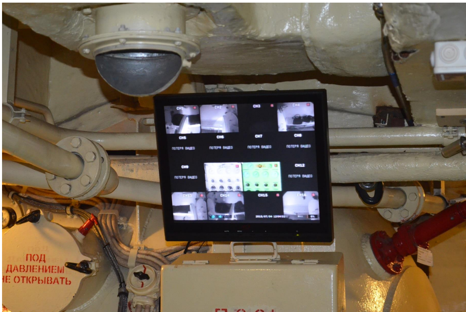
Видеомонитор системы, работающий в режиме одновременного наблюдения за всеми объектами
