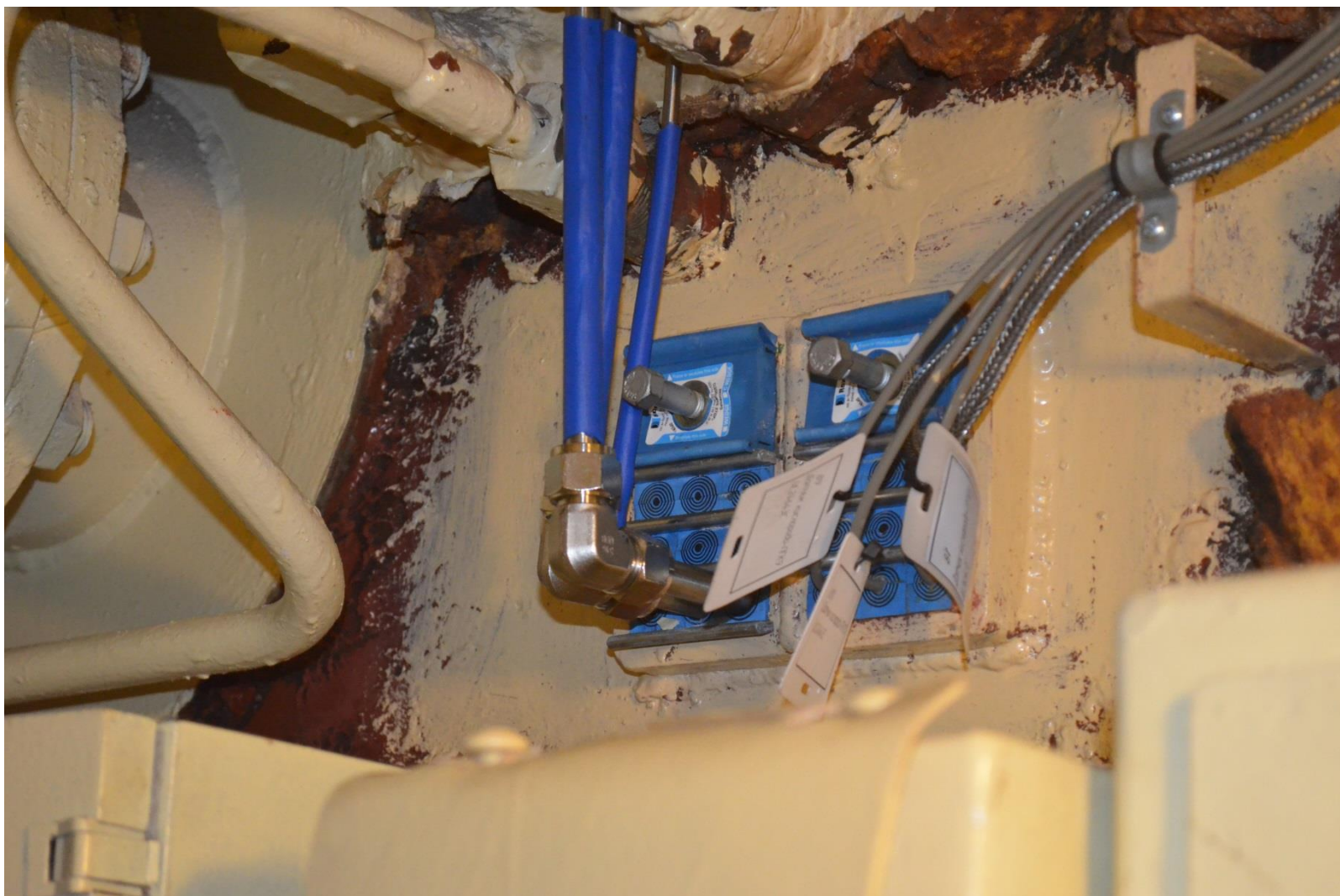
Прохождение кабелей электрической сети СЖО через переборку класса «А»
