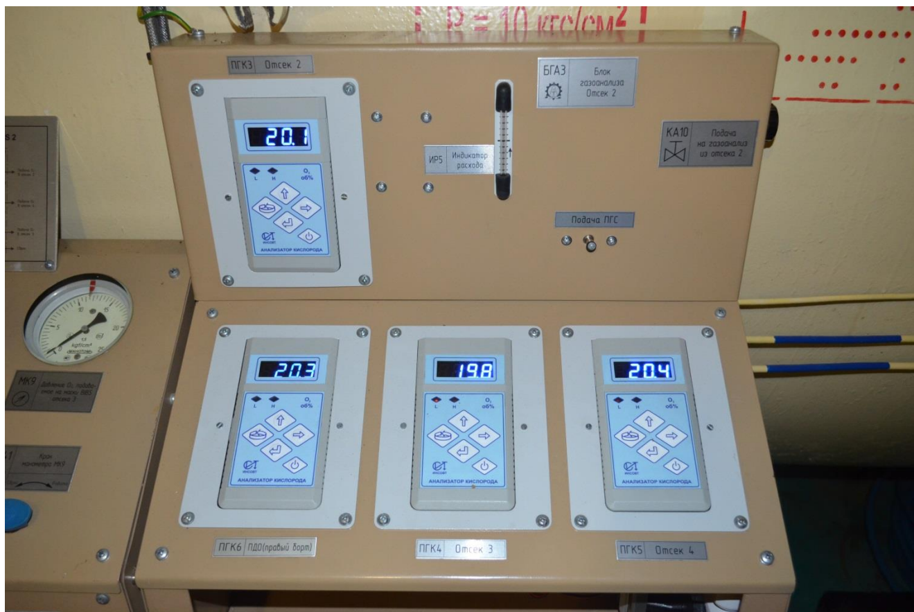
Блоки управления и индикации газоанализаторов ПГК-06-25Р1, контролирующие кислород в отсеках барокамер правого борта
