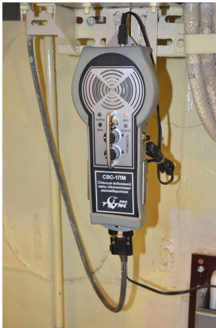
Станция связи с помещением гелиевокислородных баллонов. Установлена на рабочем месте руководителя спуска.
