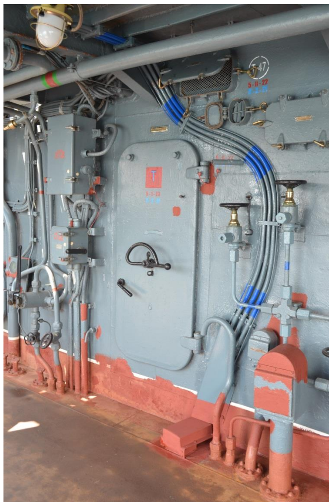
Трубопроводы сброса кислорода из пультов и масок стационарной дыхательной системы, расположенных по левому борту судна
