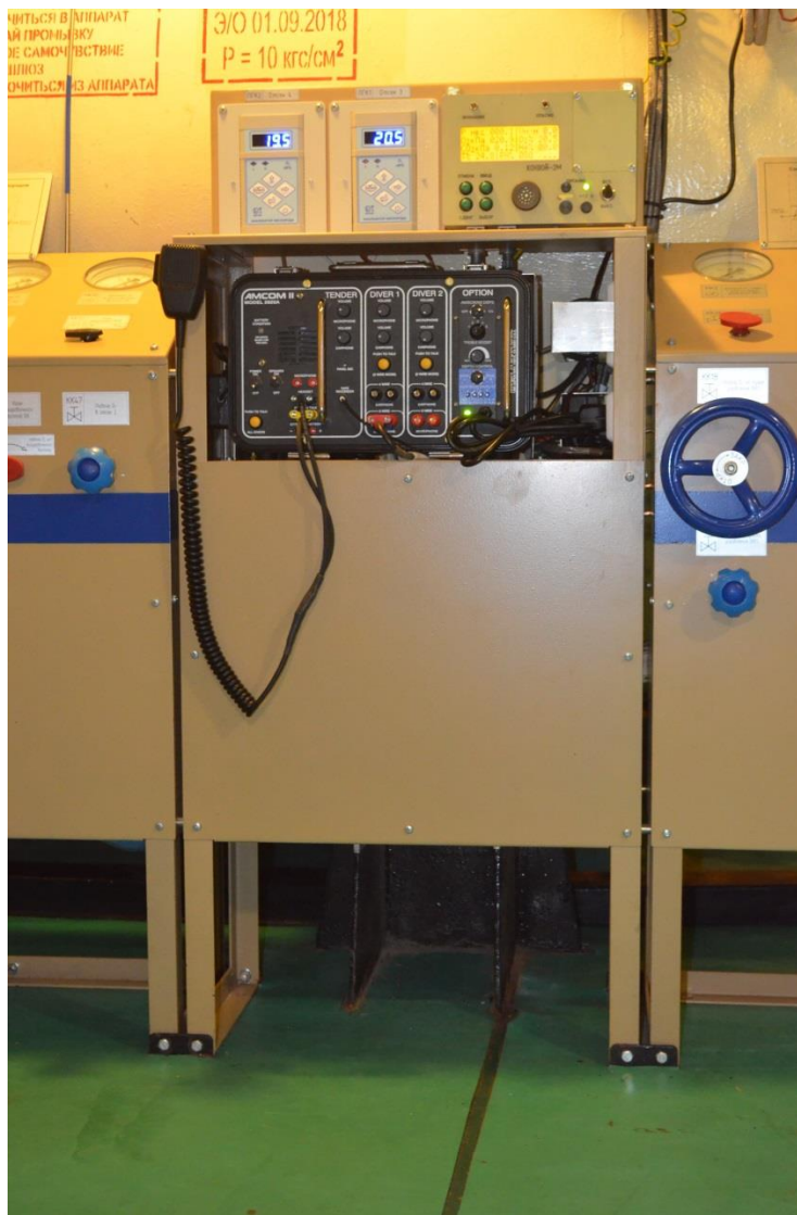
Станция связи с отсеком №2 (медицинским) барокамеры левого борта
