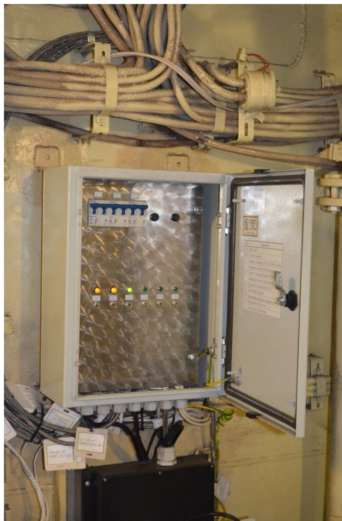
Электрический щит управления СЖО
