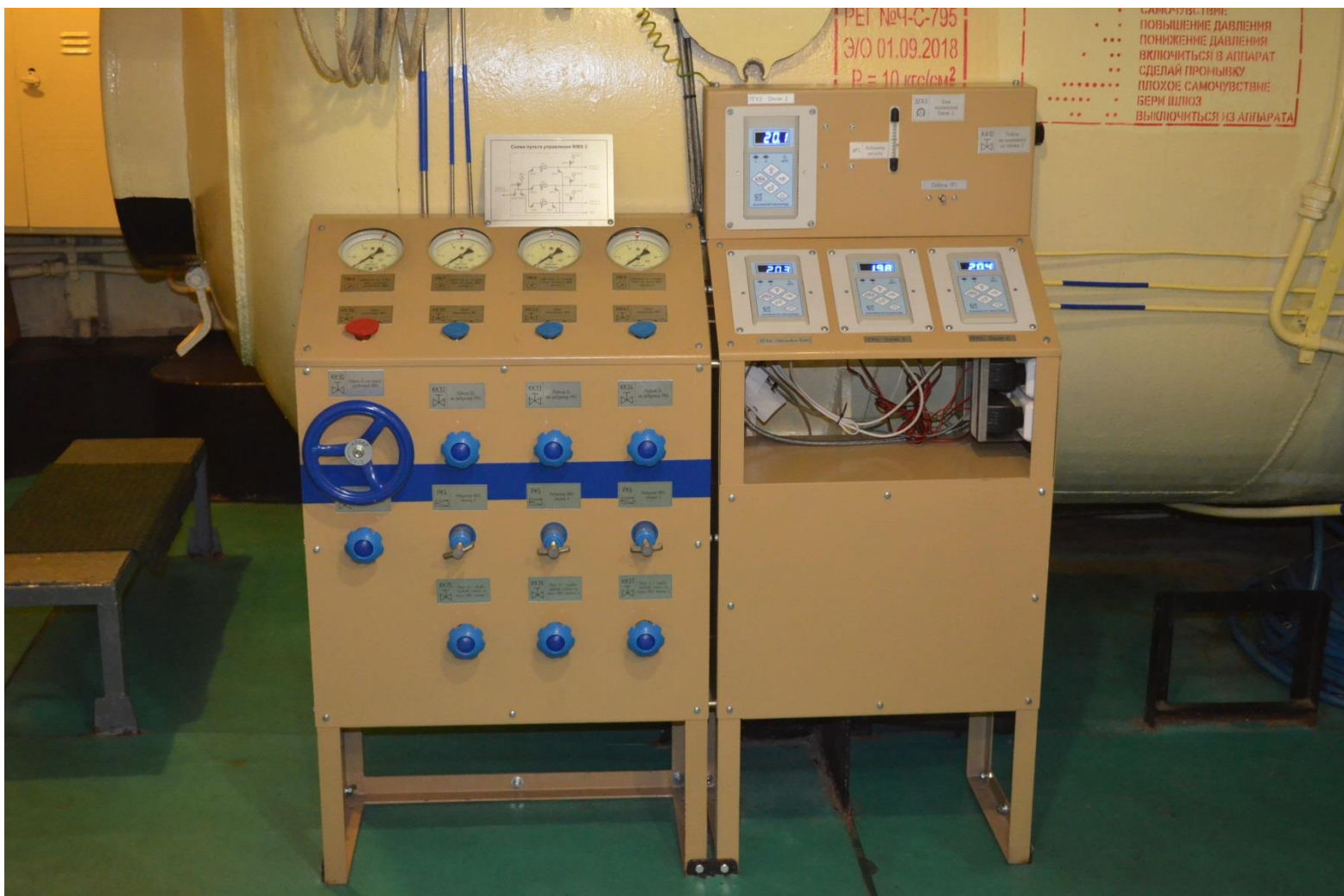
Полка газоанализа (справа) отсеков барокамер правого борта судна
