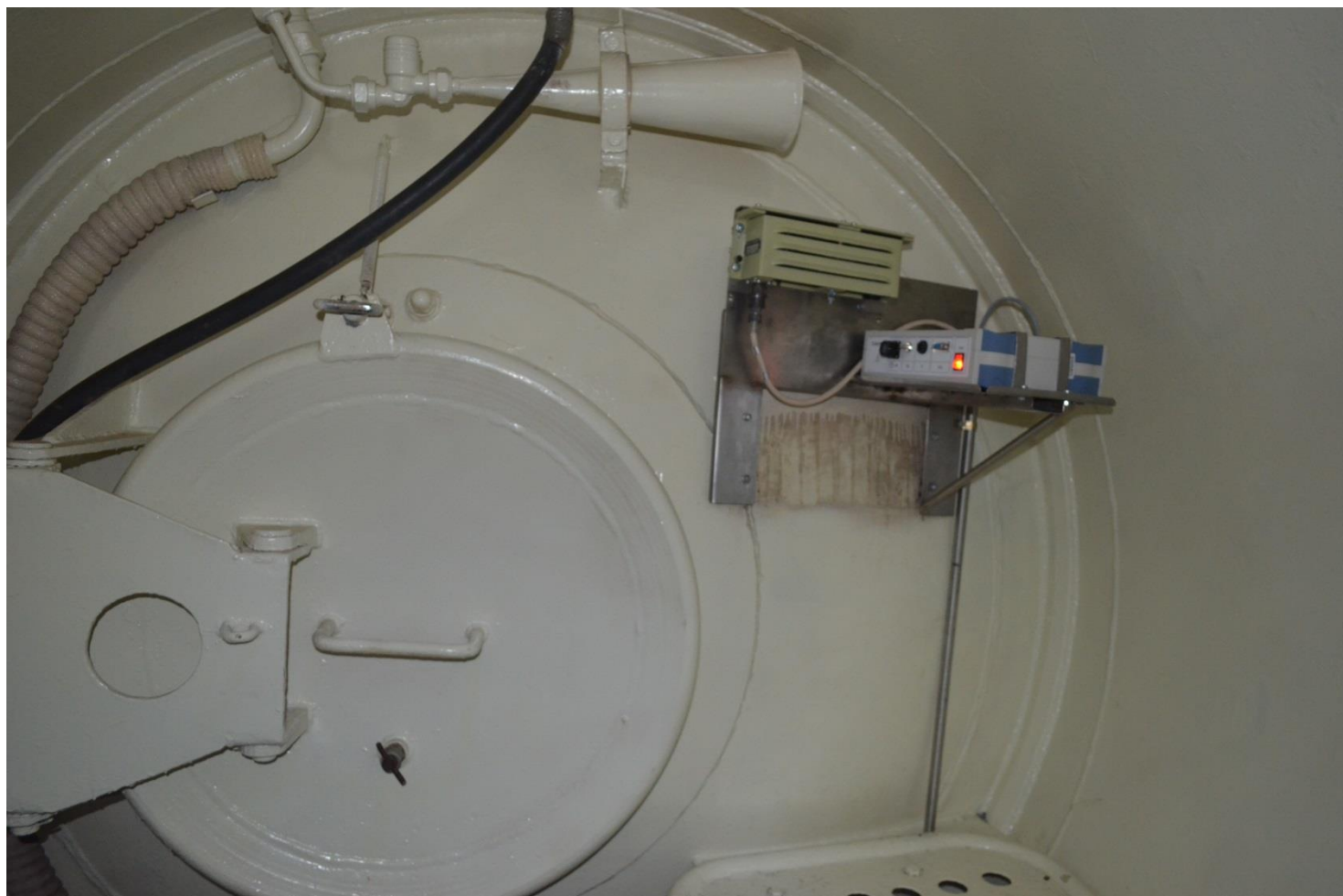
Блок датчиков газоанализатора «КОНВОЙ-2М» (зеленоватого цвета), установленный в отсеке №2
