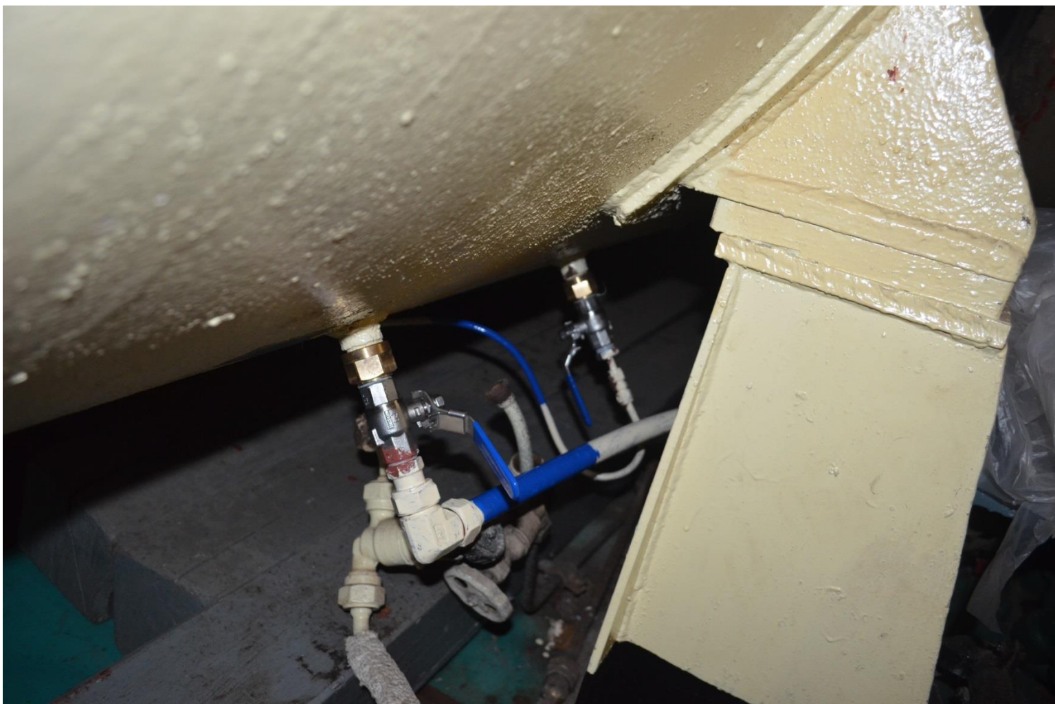
Ввод трубопроводов кислорода низкого давления в отсек барокамеры на коллектор стационарной дыхательной системы
