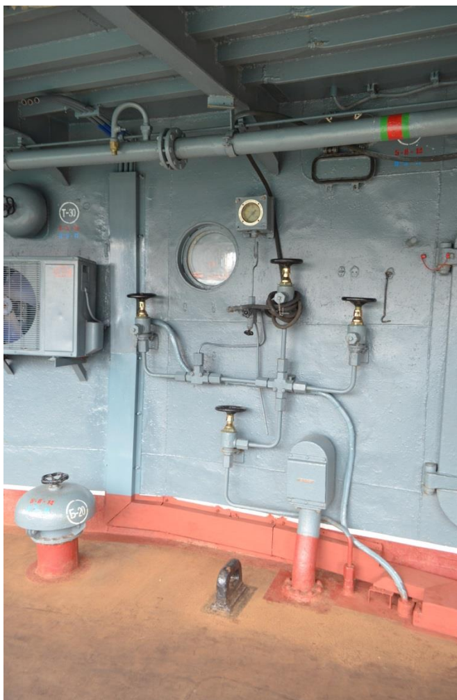
Трубопроводы сброса кислорода из пультов и масок стационарной дыхательной системы, расположенных по правому борту судна.
