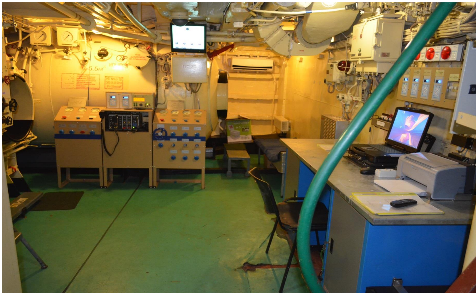
Оборудование СЖО, установленное у барокамер левого борта и на месте руководителя спуска и водолазного врача.
