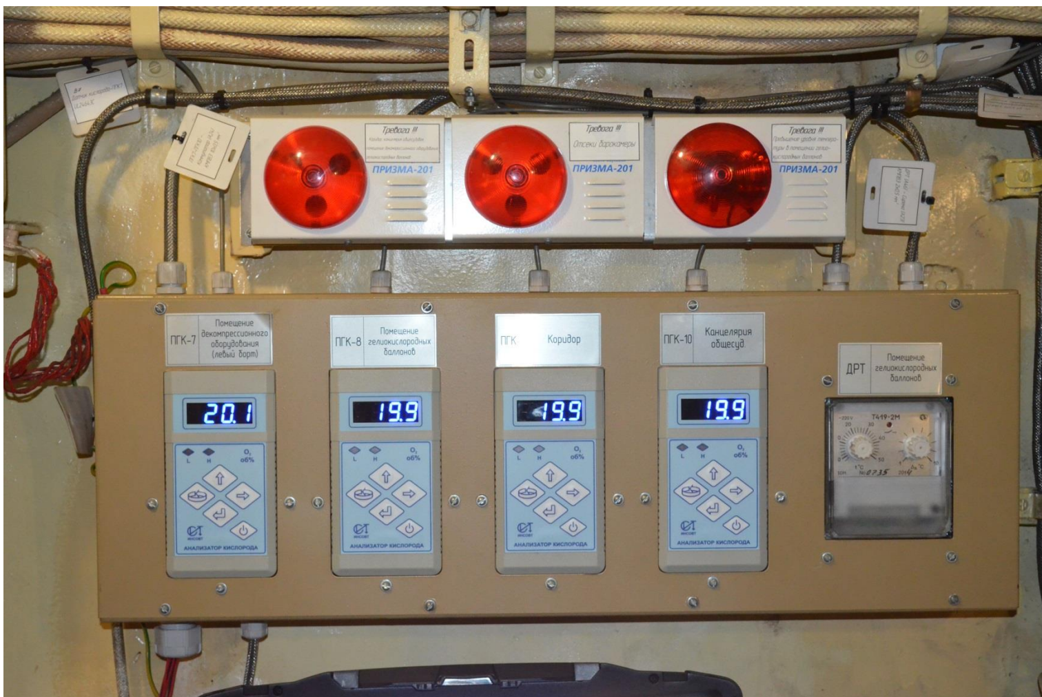
Полка газоанализа помещений судна, где расположено кислородное оборудование и панель тревожной сигнализации. Полка и сигнализации установлены на рабочем месте руководителя спуска.
