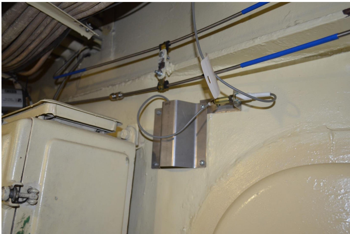
Датчик газоанализатора ПГК-06-25Р1, установленный в помещении декомпрессионного оборудования
