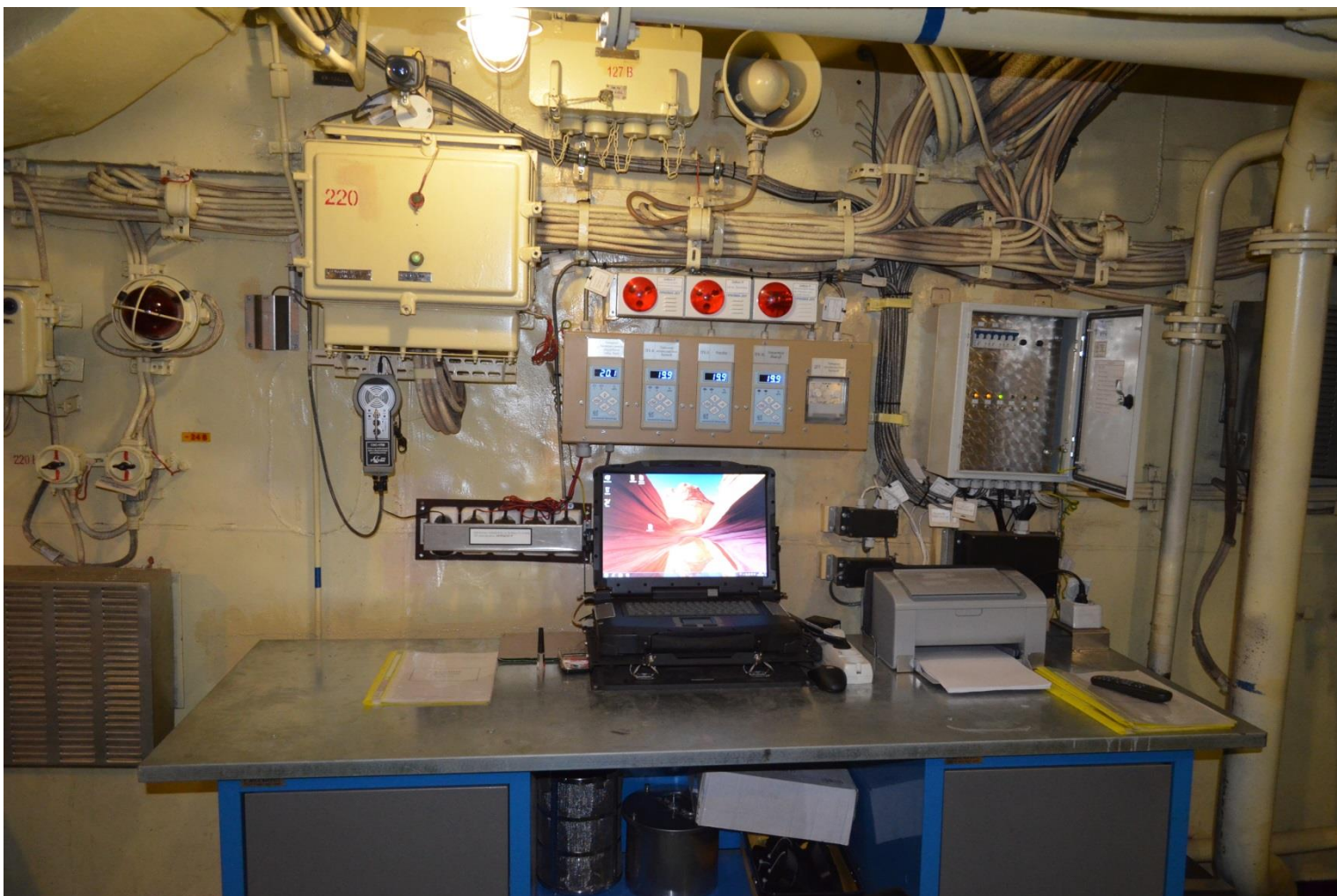
Расположение электрического щита управления СЖО в помещении декомпрессионного оборудования судна
