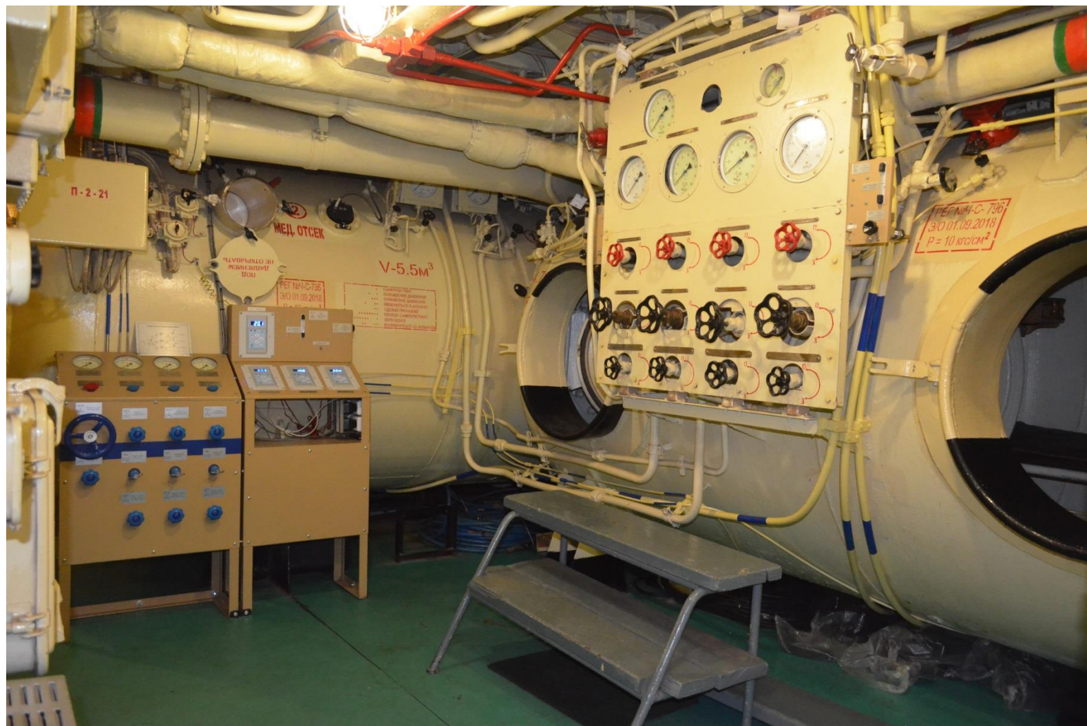
Оборудование СЖО, установленное у барокамер правого борта
